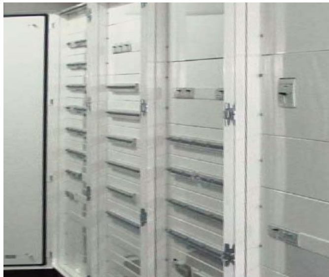
La unificación de toda la aparata del cuadro general bajo marca Hager, consigue una absoluta integración estética en este hotel de autor.
