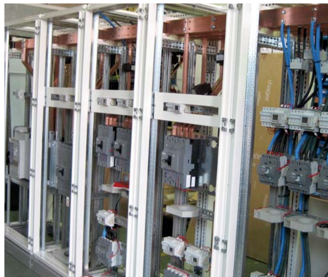
El cuadro general de esta instalación es una clara exposición del sistema de distribución y protección de Hager.
